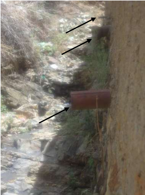
Foto 72: 3 tuberías de aguas servidas salen directamente al río
