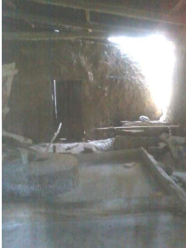
Foto 13. Techo por reparar en Rodeo Grande 1.
